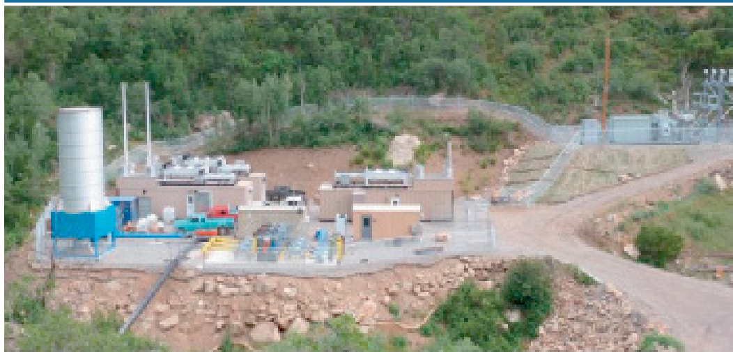
图 9.9 Elk Creek 废弃煤矿瓦斯发电项目
