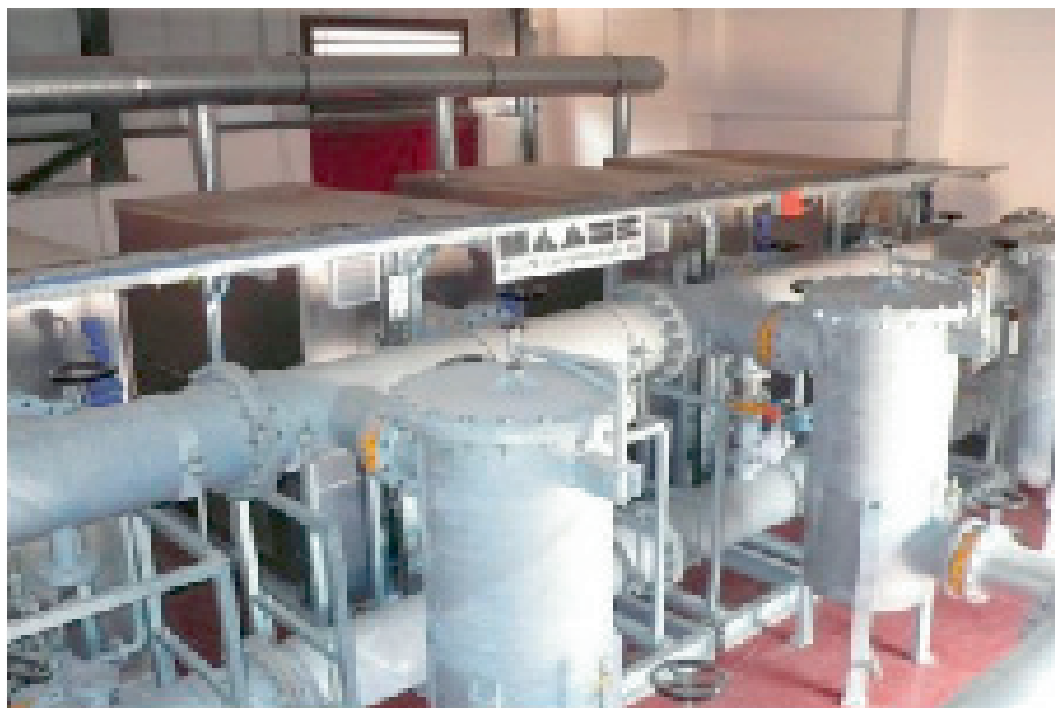
图 9.5 Stillingfleet 煤矿瓦斯抽采装置
